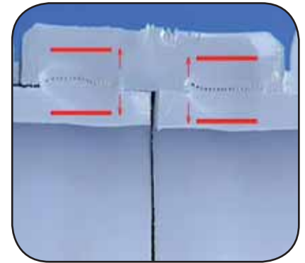
Место сварки имеет толщину материала превышающую толщину стенки трубы
